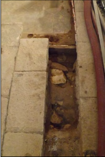
Vista del punt de connexió entre la Cala 1 i la rasa on s'observen les restes de la claveguera
